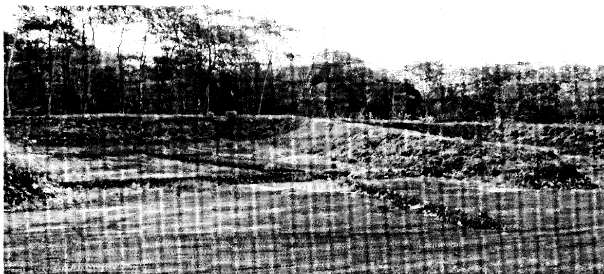
図6 改修されたタファイガタ処分場。コの字型に築かれた土の堰堤の内側に、浸透水を集排水するための管が走り、そのまわりに栗石が組んである。管が交差する中央箇所と手前の端の所に、それぞれガス抜き管が設けられている。 2003年9月 筆者撮影
